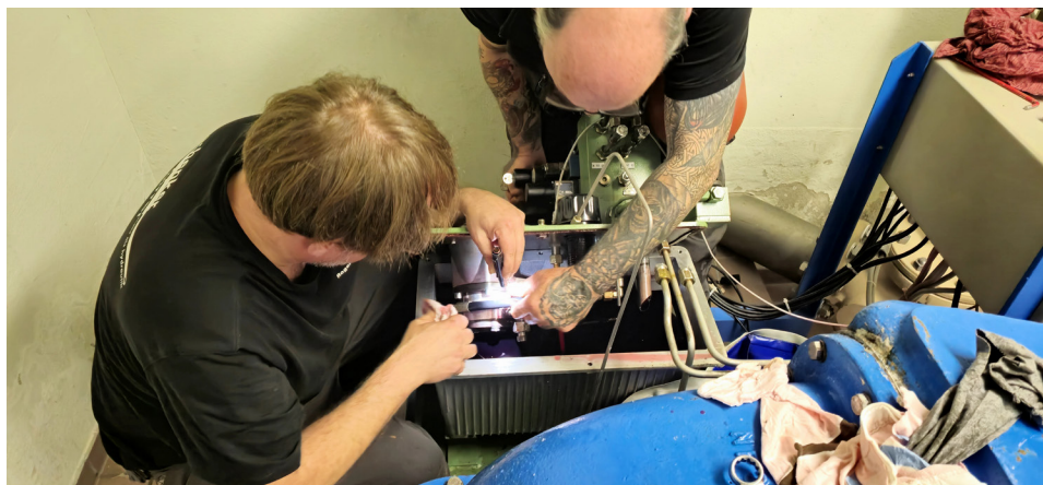
Revisiun digl agregat hydraulic, ovra Pardi
